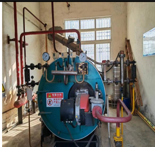
图 5 本项目依托燃气导热油炉
