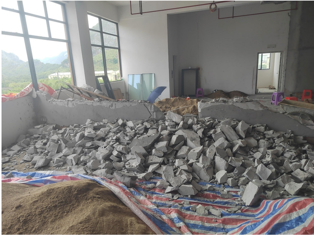
图 1 墙体倒塌现场如情况所见
