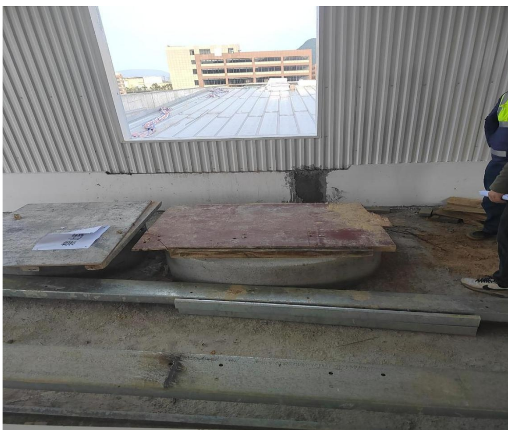
图 1 事发后调查组人员到现场看到恢复事发孔洞口的防护的照片
