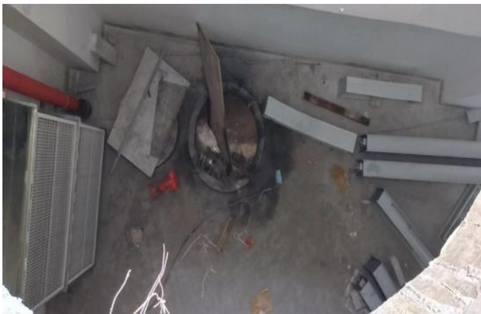
图 2 事发后二楼设备预留洞口的损坏情况
