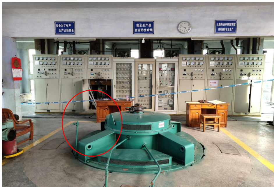
图1 二车间三号机组第一排配电柜,其中左三为发生短路的并网配电屏
