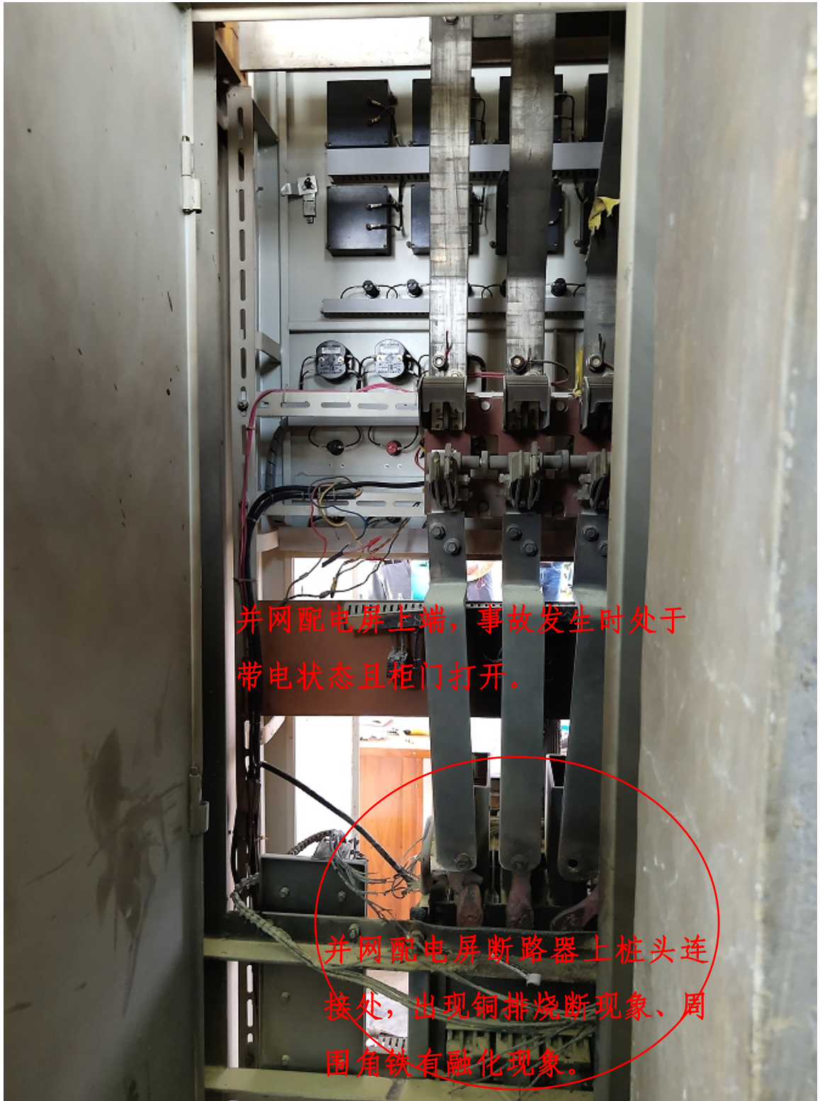
图3 二车间三号机组第一排配电柜的并网配电屏背面
