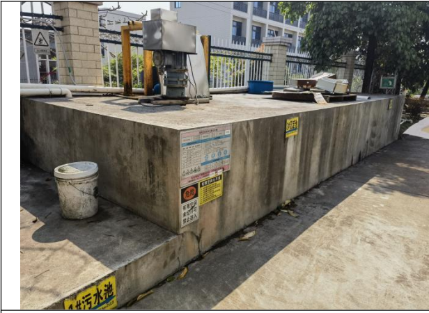
生活污水处理池
