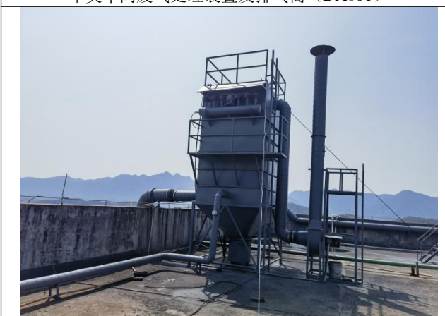
丙类车间投料废气布袋除尘器及排气筒 DA004
