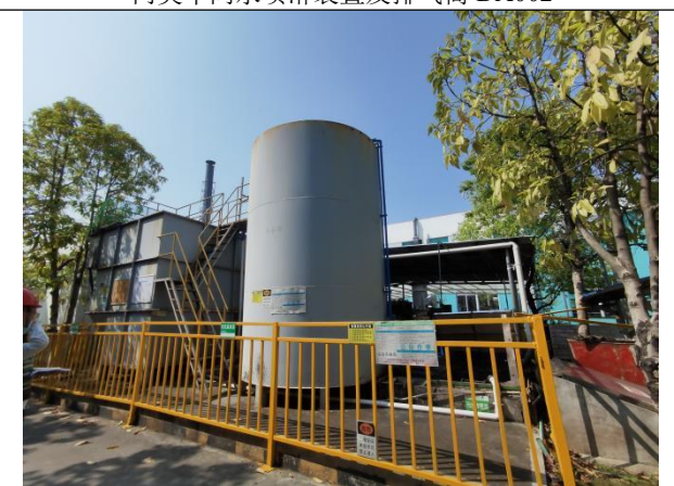
生产废水治理设施
