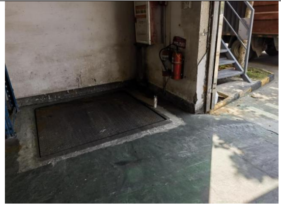
危废间内部收集池
