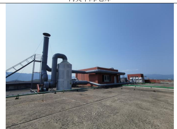
丙类车间水喷淋装置及排气筒 DA002
