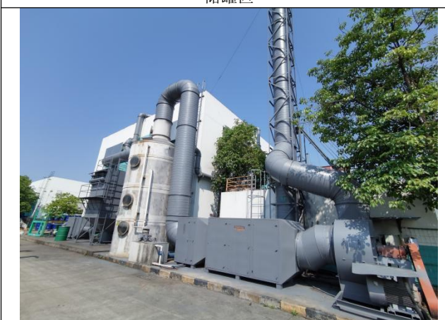
甲类车间废气处理装置及排气筒 (DA001)
