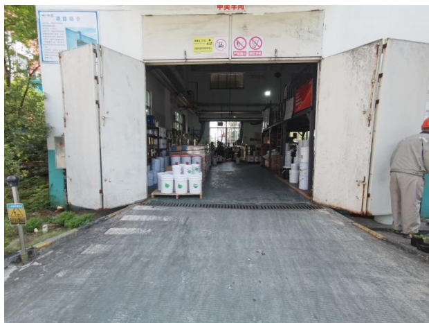
车间门口收集沟
