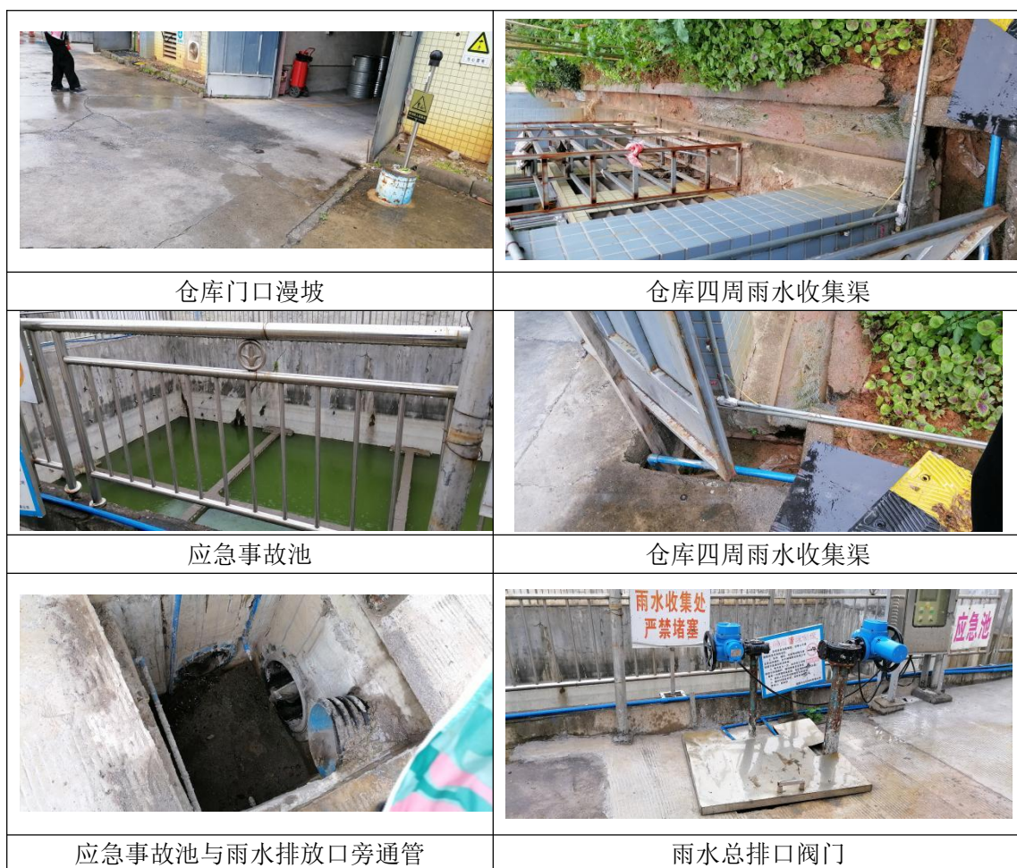
图7.2-1 环境风险防范措施现场照片
