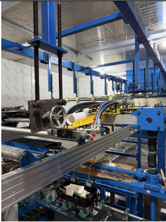
发泡设备（放置在密闭的发泡熟化间）
