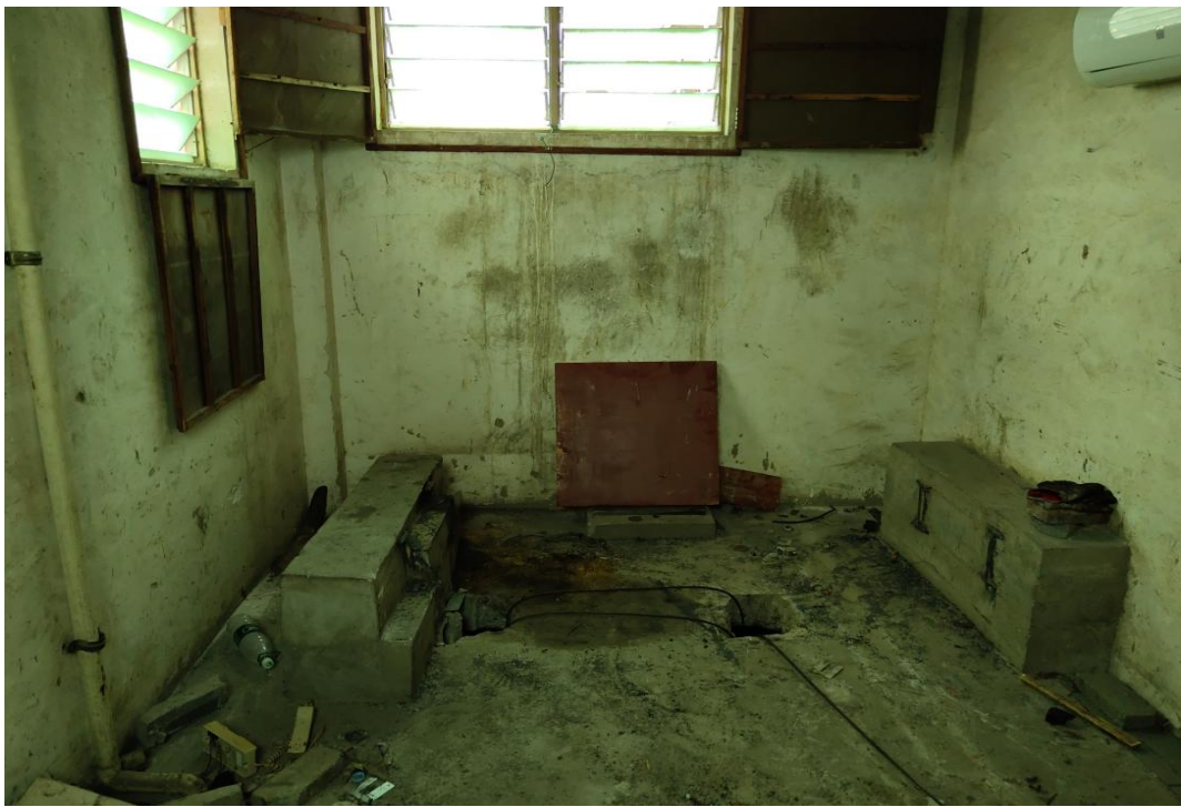
图 3 和平广场住宅楼 11 楼电梯机房
