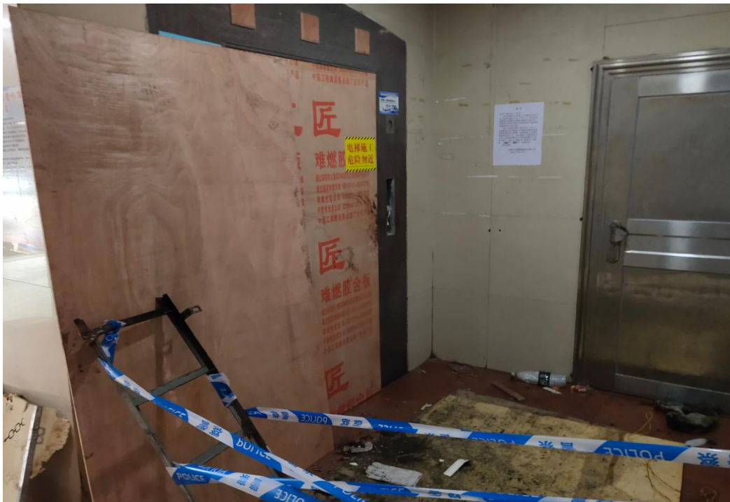
图 4 和平广场住宅楼 1 楼电梯门孔（事故后已封闭）
