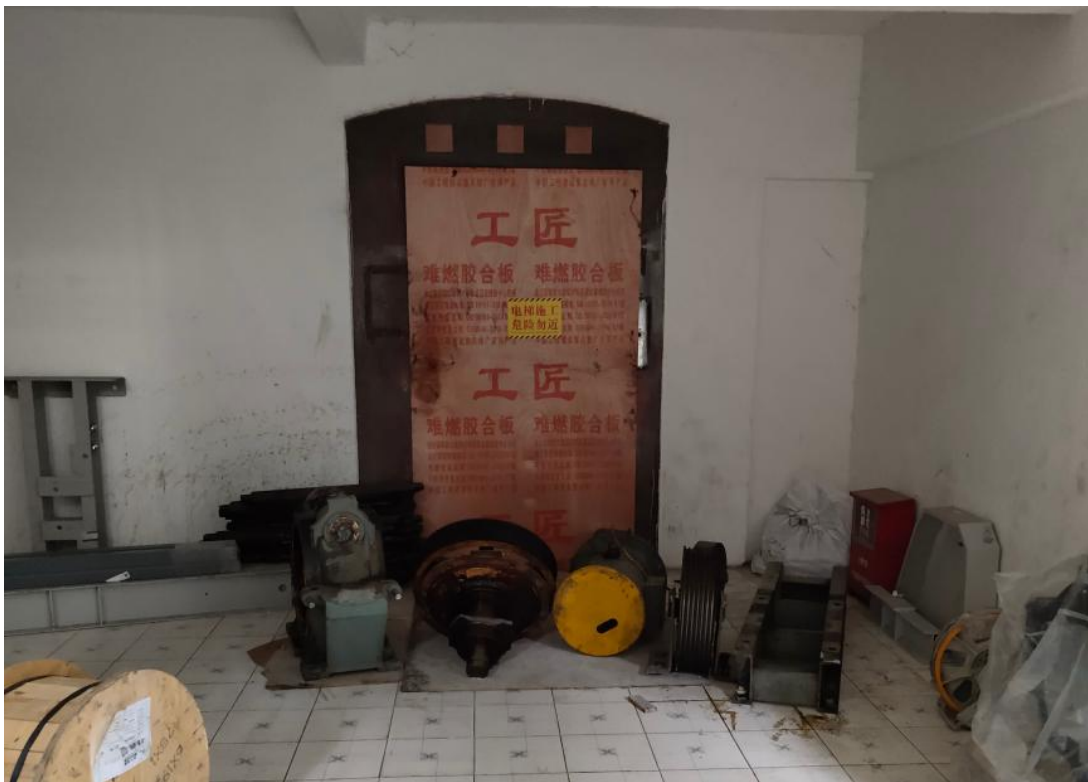
图 2 和平广场住宅楼 10 楼电梯门孔（事故后已封闭）
