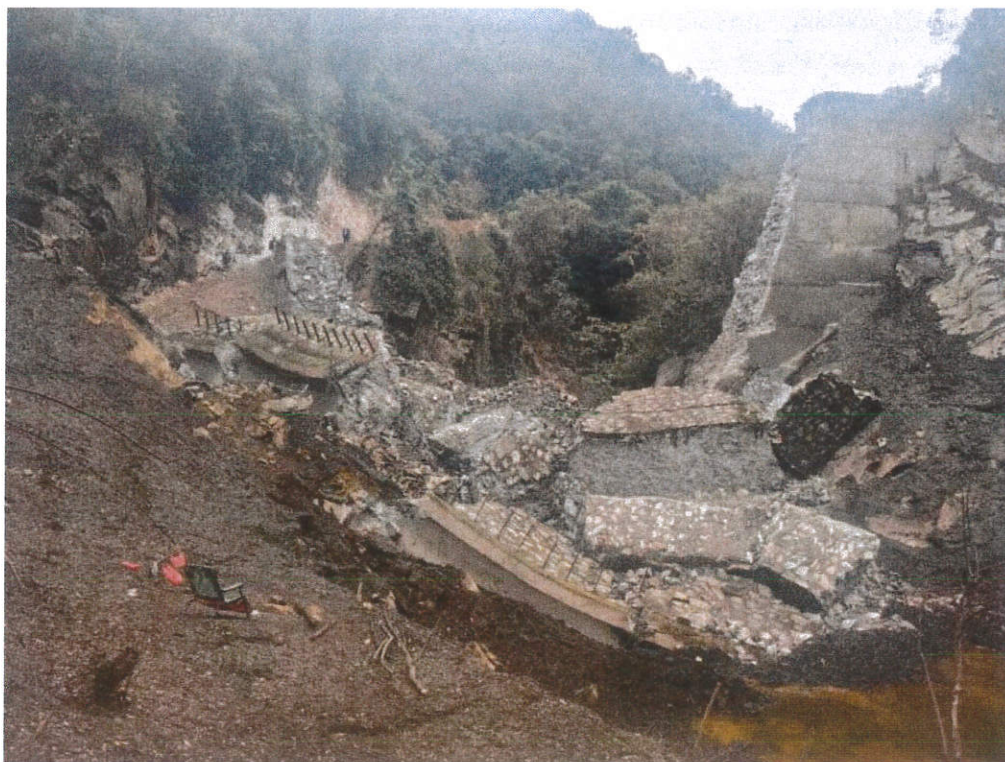
图3 洋乙坑水电站水坝（事故发生后）
