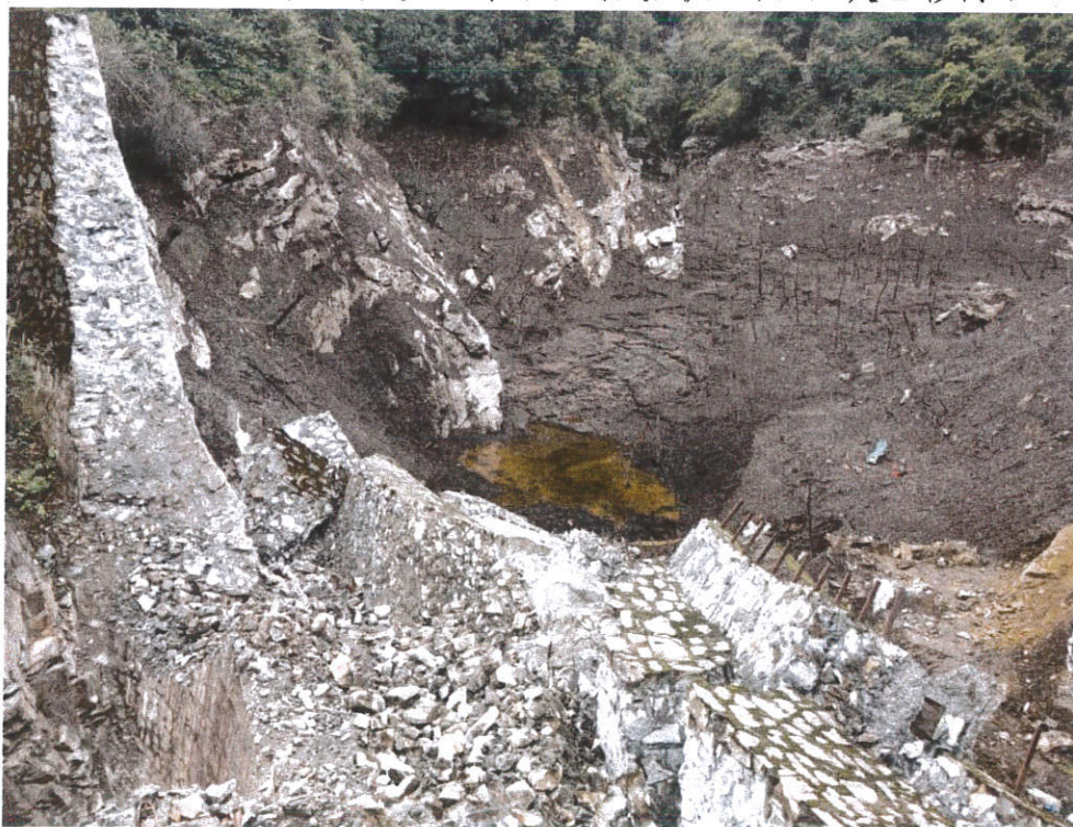
图 2 洋乙坑水电站水坝（事故发生后）
