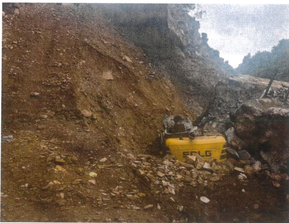
图 1 涉事挖掘机（事故后挖掘机上方石块已移除）
