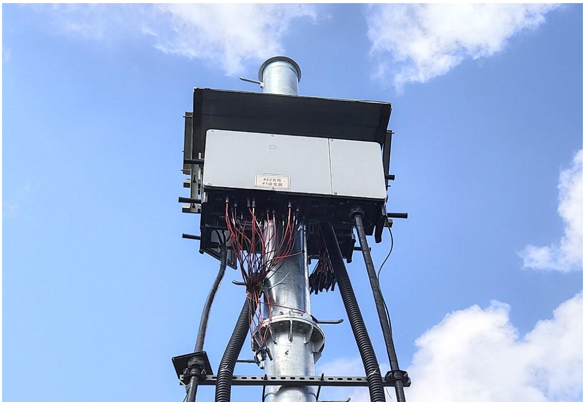
图 3 #2201 逆变器直流电缆部分拔除
